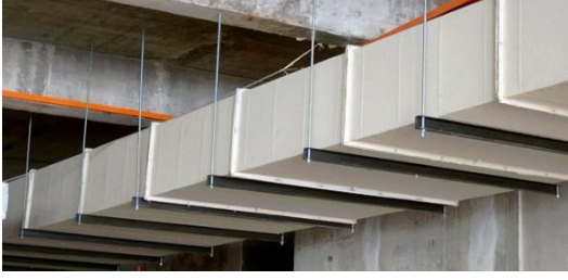
Şekil 1. Bir fabrikanın havalandırma kanalı
